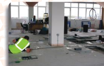
Instalações Elétricas em Geral
